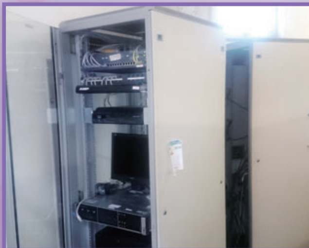
舊校地下新電腦伺服器室
